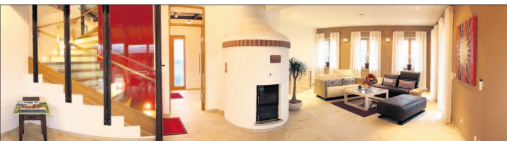
Der große, runde Pufferspeicher, der das Konzept des Sonnenhauses erst ermöglicht, als Gestaltungselement bewusst genutzt.
